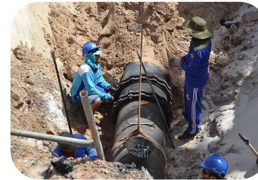
Material de construcció (tubs, connectors, vàlvules)
